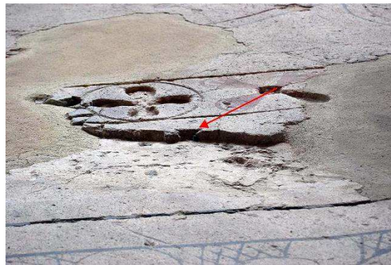
Abb. 21: Absenkungen am Gipsestrich der Klosterkirche Ilseburg
