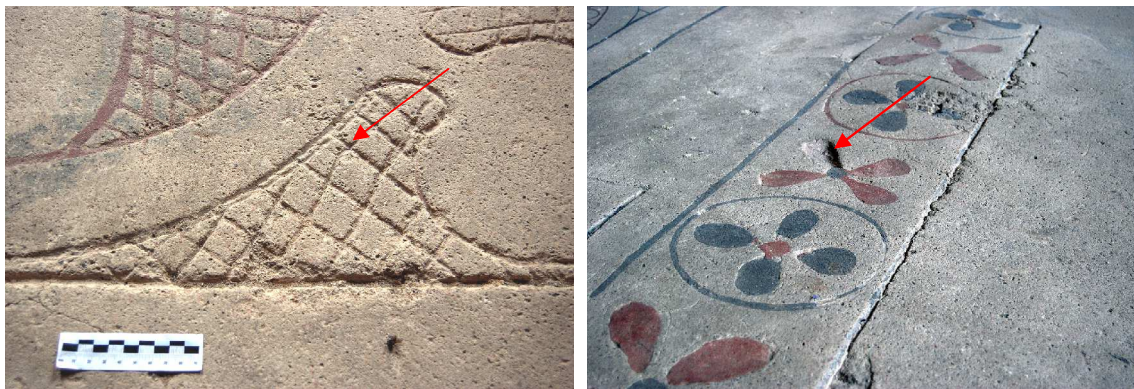
Abb. 11 / 12: Verloren gegangene Inkrustierungen im Gipsestrich der Klosterkirche Ilsenburg
