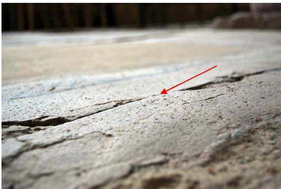
Abb. 20: Aufwölbung am Gipsestrich der Klosterkirche Ilseburg
