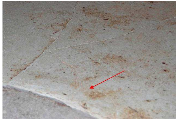
Abb. 15: Verfärbungen des Gipsestrichs im Treppenhaus des Schlosses Stolberg
