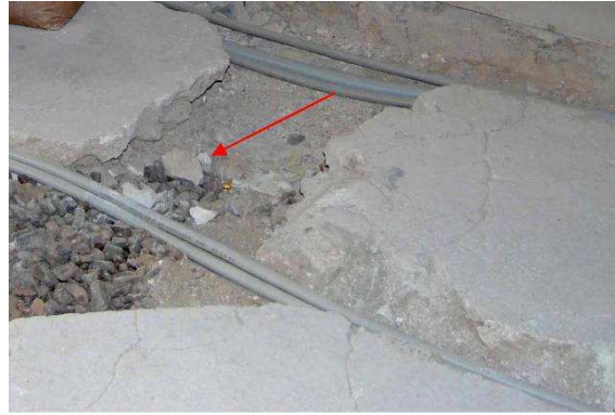
Abb. 19: Fehlstellen an einem Gipsestrich
