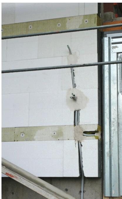
2 So bitte nicht! Das Praxisbild zeigt eine unsachgemäße Leerrohr-/Kabelanordnung im Bereich des Brandriegels.
