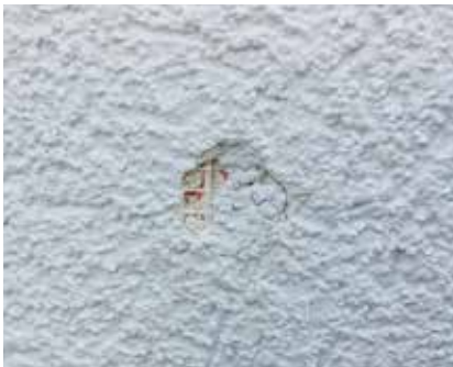
Mechanischer Schaden in der Fassade
